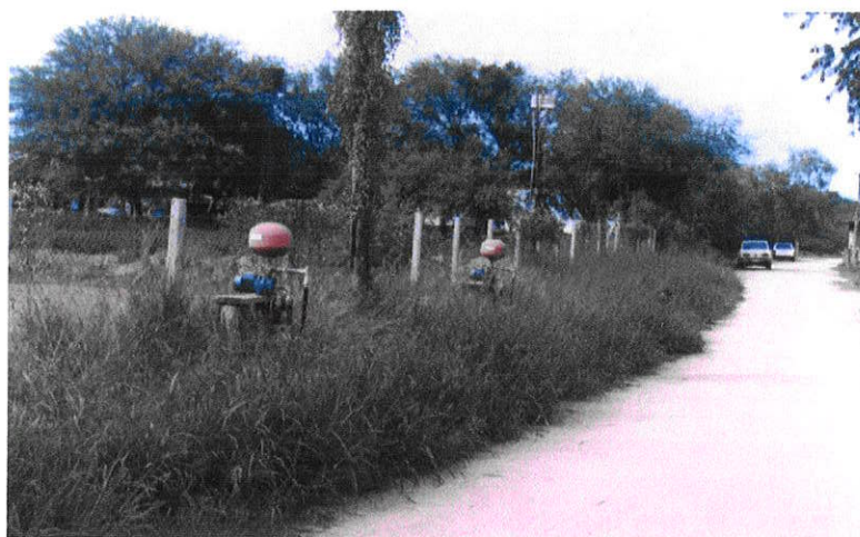
Figura 8.2 Bombas para exploração da água subterrânea, fora do perímetro de proteção (alambrada) do reservatório de infiltração.
